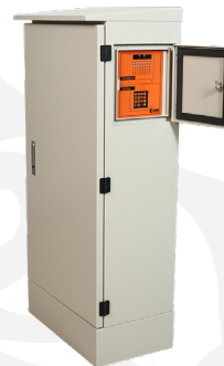
ตู้ควบคุมไฟจราจร ข้ามทางรถไฟ
